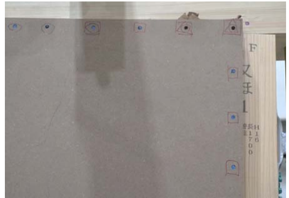
面材の縁切れ、くぎの引抜け
