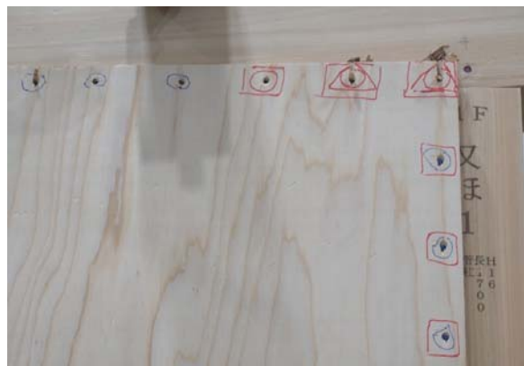
面材の縁切れ、くぎ頭のめり込み
