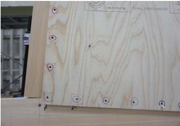
くぎの引抜け、頭のめり込み
