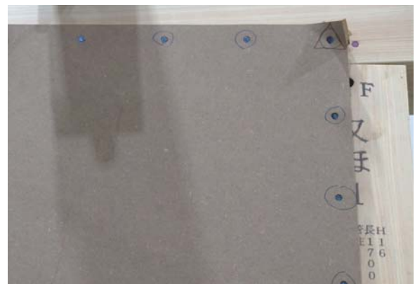
面材の縁切れ、くぎ頭のめり込み
