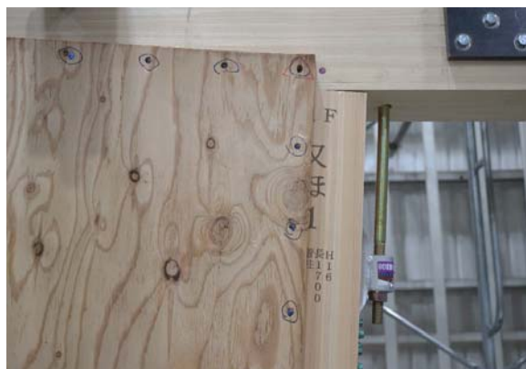
面材の縁切れ、くぎ頭のめり込み
