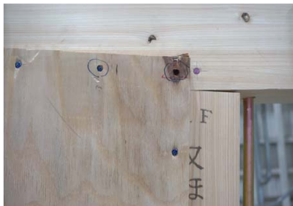
面材の縁切れ
