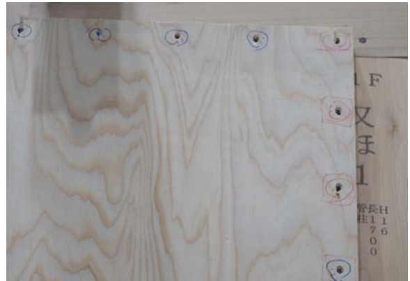
くぎの引抜け、頭のパンチングアウト
