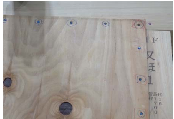
面材の縁切れ、頭のめり込み
