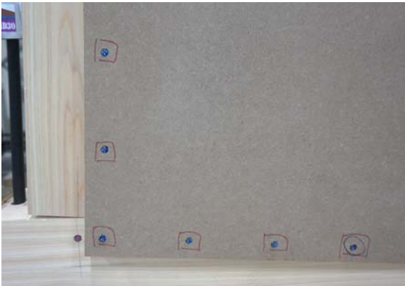
くぎの引抜け、頭のめり込み
