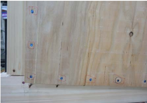
くぎの引抜け
