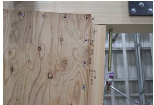
面材の縁切れ、くぎ頭のめり込み
