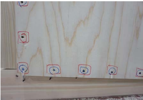
くぎの引抜け、頭のめり込み
