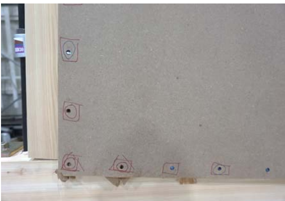
面材の縁切れ、くぎの引抜け
