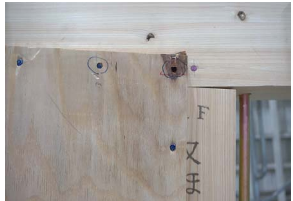
面材の縁切れ
