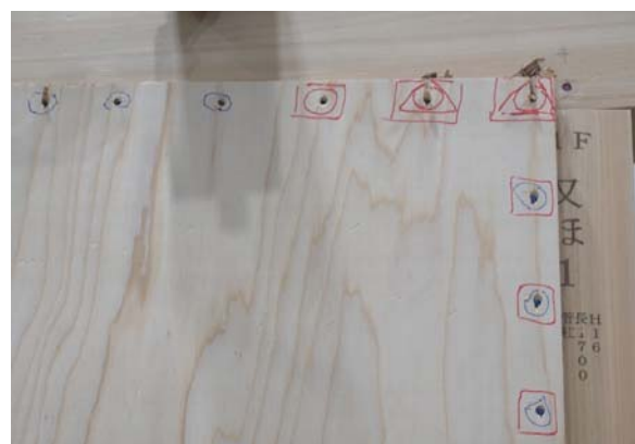
面材の縁切れ、くぎ頭のめり込み
