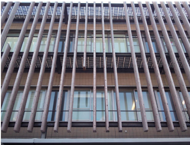
鶴岡市総合保健福祉センター（山形県） （RC造で内・外装木質化）：外壁面の木質系ルーバーの塗り替えに配慮し、キャットウォークを設置した。
