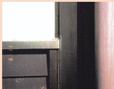
写真2 外壁と玄関柱(RC造の上に50mm厚の板を取り付けた物)との間に隙間が生じた。補修のため、シーリング材を充填している。(小学校) 8)
