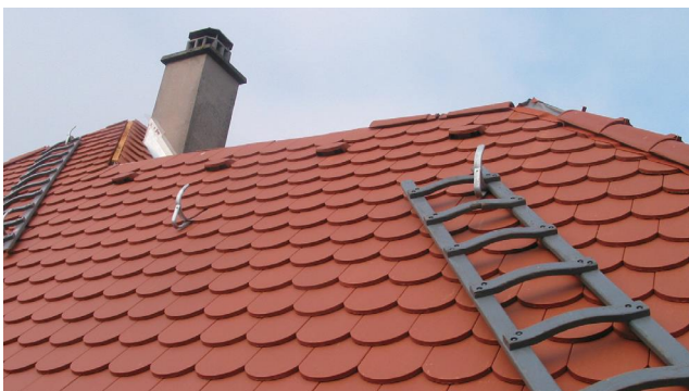
写真2 屋根のメンテナンスのために予め屋根面に取り付けられたフック金物（ドイツ） 撮影：岩元 創
