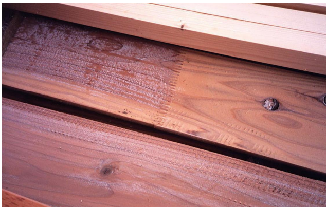
写真5 防火処理木材の白華現象
