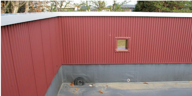
写真1 あすなろ幼稚園 防水立ち上がりを十分に確保している。
