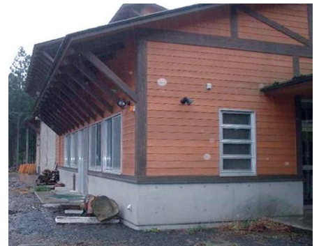
写真4 軒やけらばの出による保護効果の例(栃木県21世紀林業創造の森訓練棟) さらに基礎が高い場合には雨水の跳ねも少なく保護効果がより高まる。
