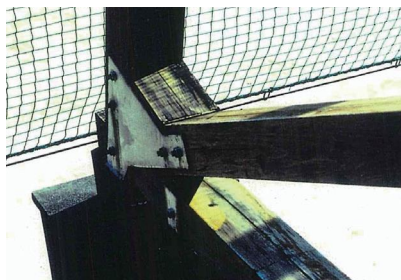
写真2 屋外露出使用の製材による梁の干割れと変色(汚損)、一部腐朽(多目的ホール) 8)
