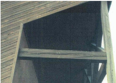
写真1 屋外露出使用の製材による梁の干割れ(研究施設) 8)
