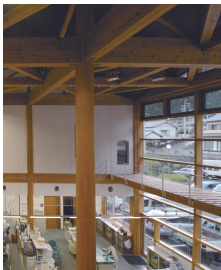
写真3 春野協働センター 吹き抜けのガラスのカーテンウォールの中に設けられたキャットウォーク。
