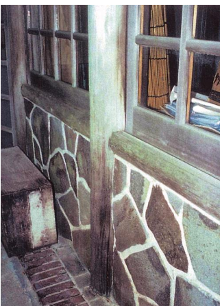
写真3 ドライブイン(築24年) 外部に露出した柱脚部が雨水によって腐朽している。 3)8)
