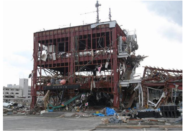
写真2 骨組みだけ残ったS造建物
