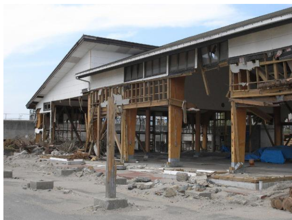
写真6 残った集成材建物（石巻市）
