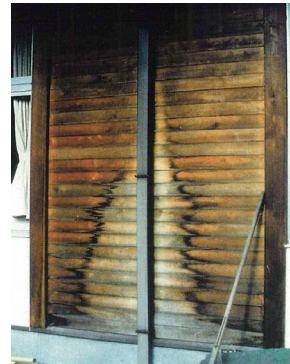
写真1 縦樋の破損による下見板の汚れ(築7年) 他の木部は軒の出が1mあるために傷んでいない。
