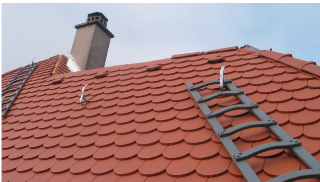
写真2 屋根のメンテナンスのために予め屋根面に取り付けられたフック金物（ドイツ） 撮影：岩元 創
