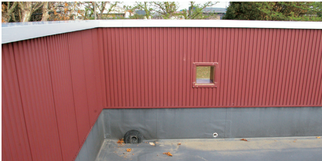
写真1 あすなろ幼稚園 防水立ち上がりを十分に確保している。
