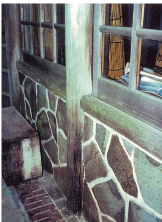
写真3 ドライブイン(築24年) 外部に露出した柱脚部が雨水によって腐朽している。 3)8)
