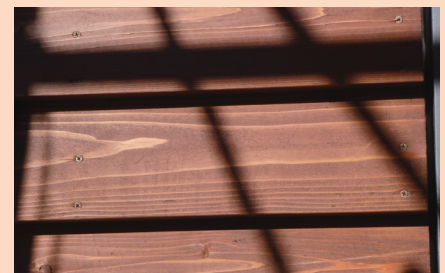
写真5 鹿沼市栗野第一小学校の下見板 一般的には召し合わせ部分でビスにて留め付けるのであるが、メンテナンスの容易性に配慮しビスが隠れないように施工した。
