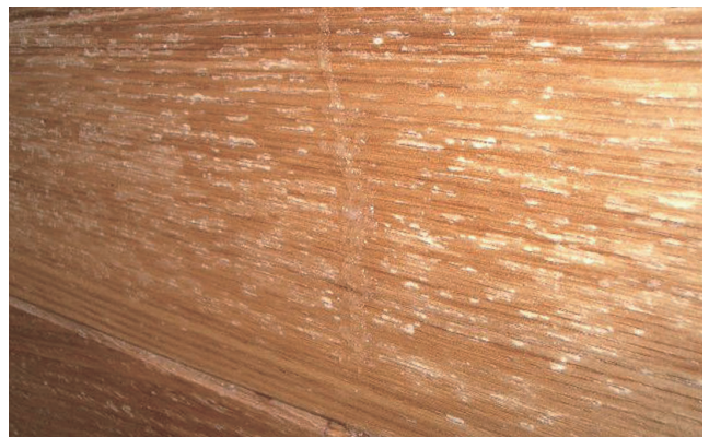
写真6 白華による塗膜の劣化
