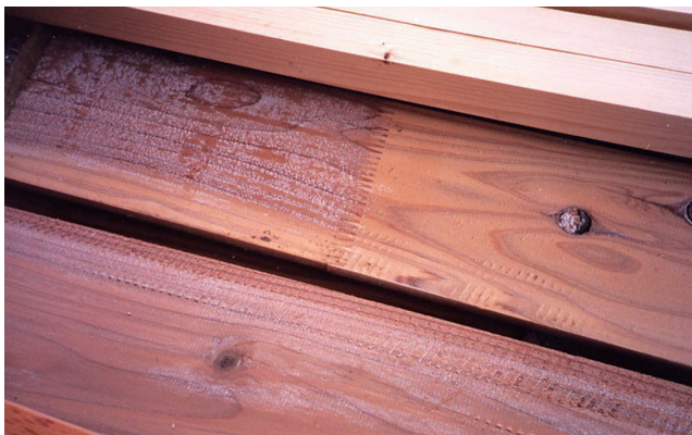
写真5 防火処理木材の白華現象
